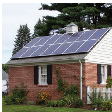
Solar PV Array
